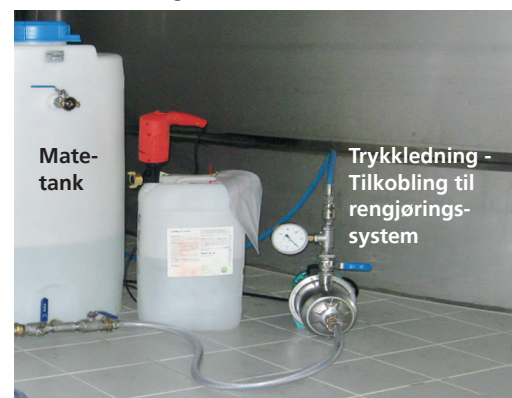
Bruk av sure rengjøringsmidler ved hjelp av separat, syrebestandig pumpe
